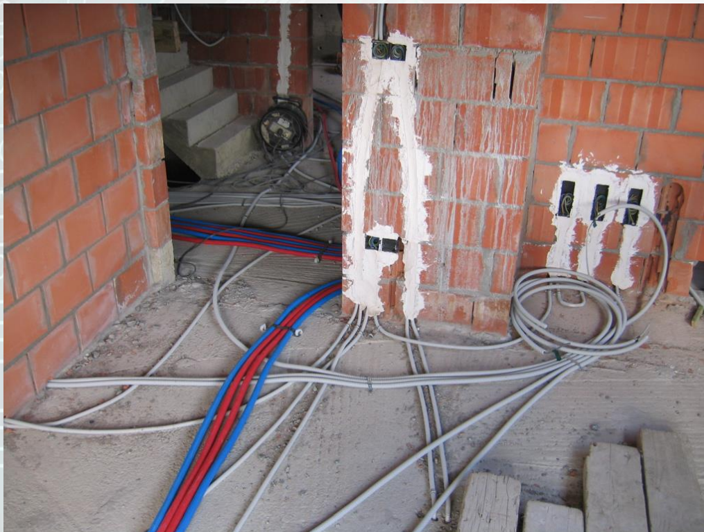
Leidingen in een ruwbouwwoning
